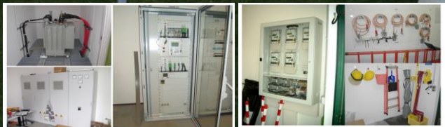
EB-Trafo AC-/DC-EB Schutz Steuerung
