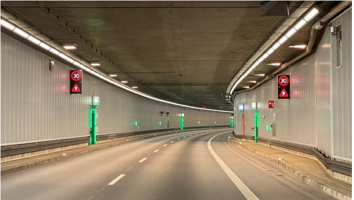
Im Münchener Petueltunnel sorgt die von SPIE installierte LED-Beleuchtung bereits für Energieeinsparungen. Copyright: SPIE
