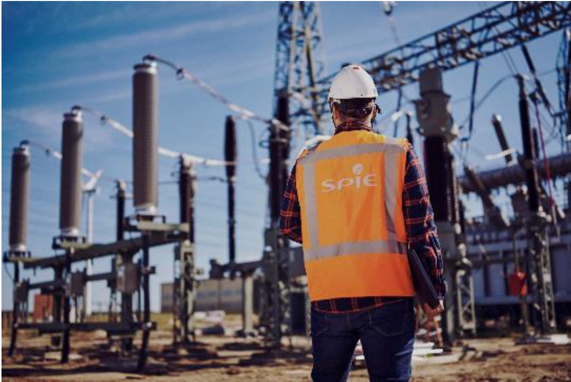
SPIE erweitert Umspannwerk.
